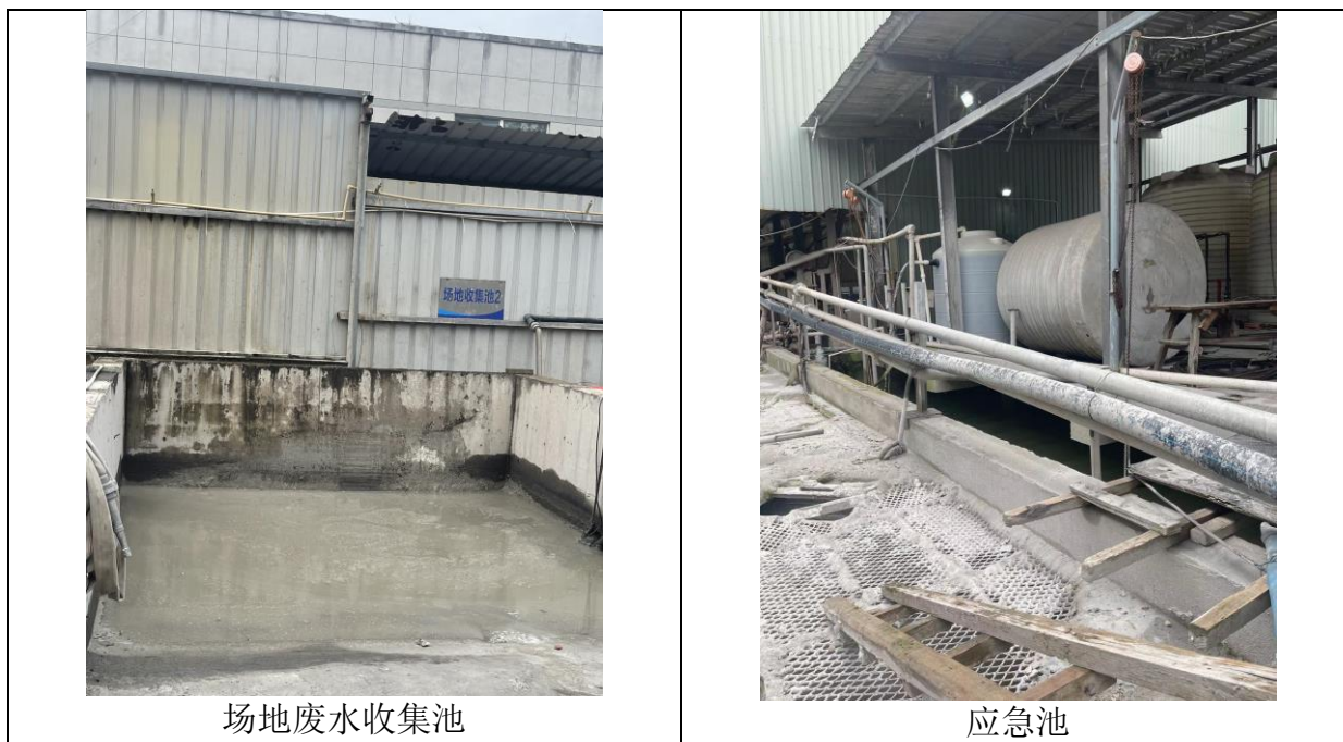
图4.1-2 废水处理设施照片
